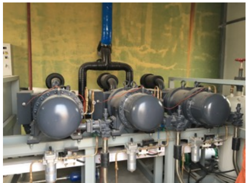
新しい全自動冷却設備
